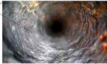
Проблема 2 Коррозия труб
